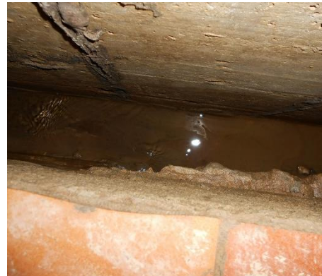
FILTRACIÓN DE AGUA EN ESTRUCTURA SUBTERRÁNEA
