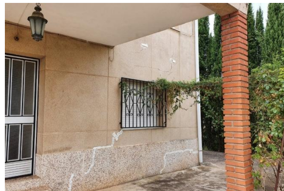
ASIENTO DIFERENCIAL VIVIENDA UNIFAMILIAR
