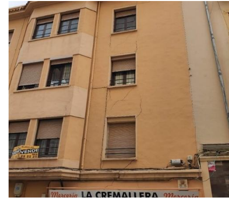
ASIENTO DIFERENCIAL EDIFICIO PLURIFAMILIAR
