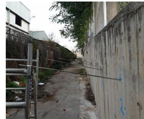
VUELCO DE MURO
