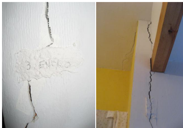
Detalle de la magnitud de algunas grietas en el interior de la vivienda.
